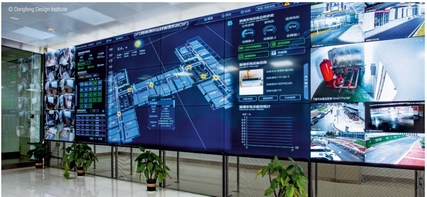
Das Gebäudemanagementsystem umfasst alle relevanten Teilsysteme. The building management system incorporates all relevant sub-systems.
